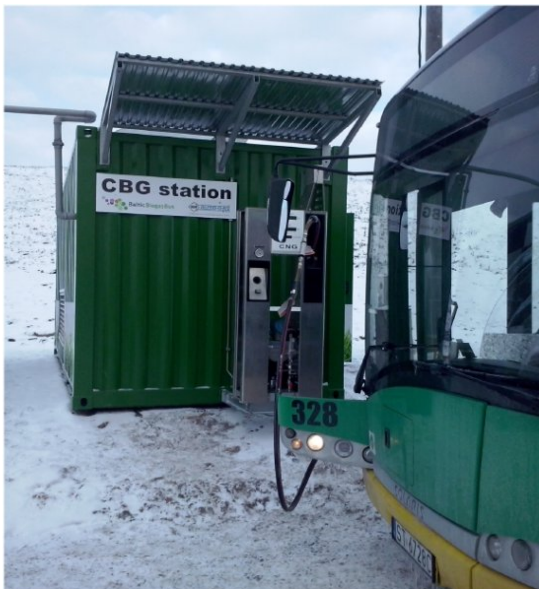
CBG — Compressed BioGas, Niepołomice
